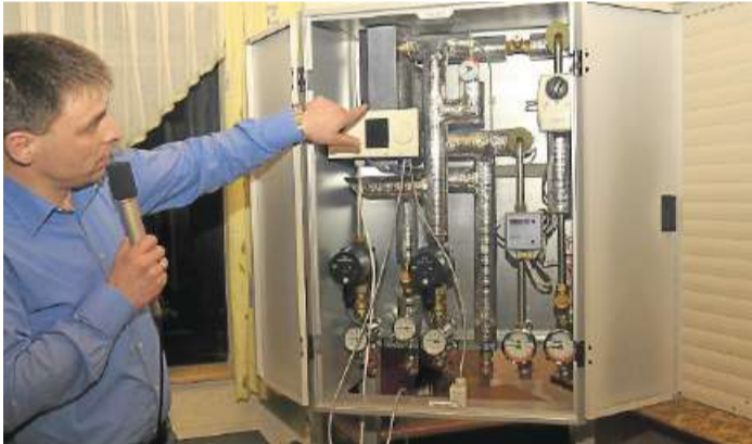
Jeder Haushalt ist mit einer Übergabestation ausgestattet.
